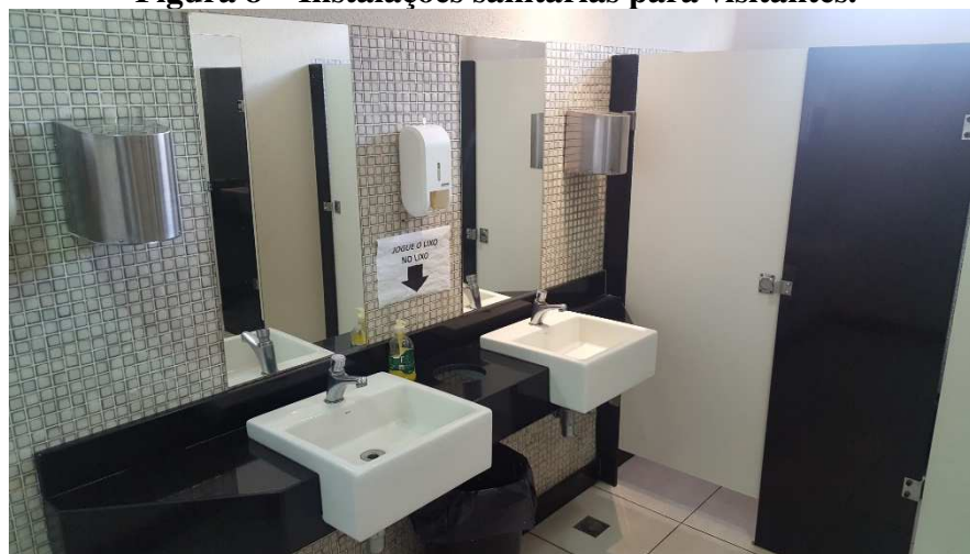
Figura 8 – Instalações sanitárias para visitantes.
