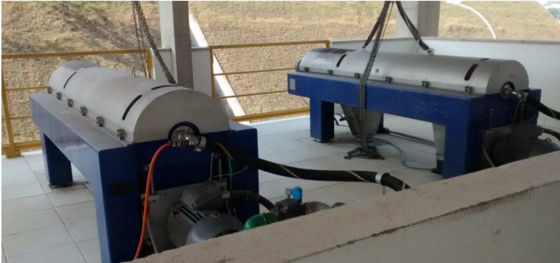
Figura 7: Centrífugas de desidratação do lodo ETE Várzea Paulista
