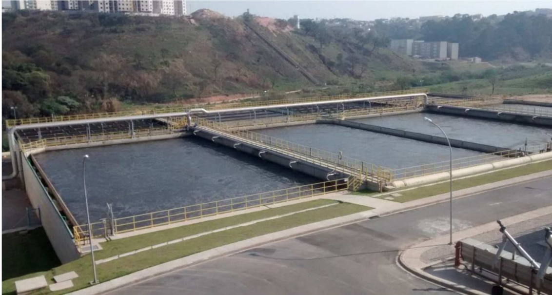
Figura 6: Reatores de lodos ativados
