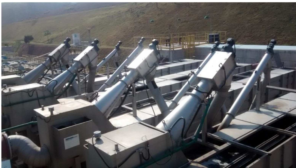
Figura 4: Unidades compactas de pré-tratamento
